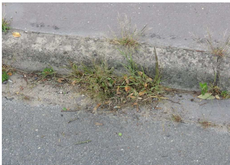
Gargouille obstruée et végétation Au-dessus de la culée - côté rive gauche
