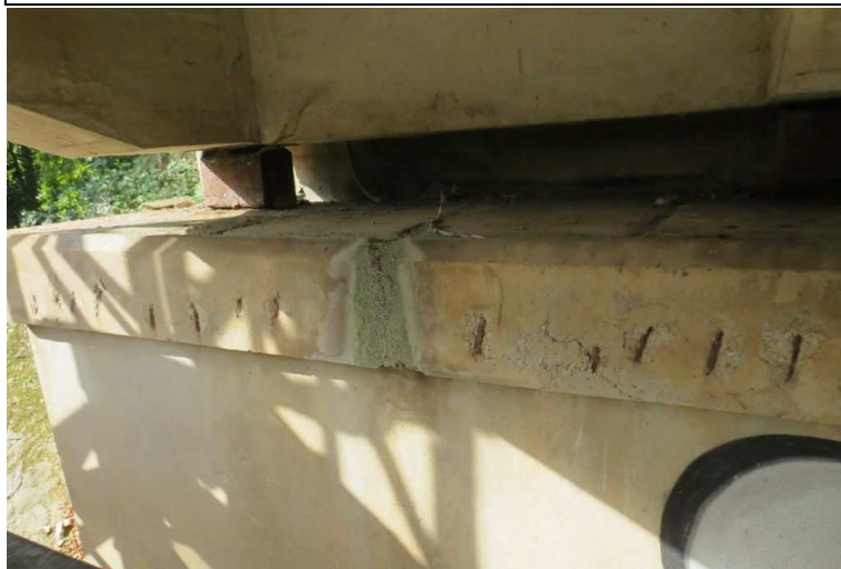
Eclat, aciers apparents corrodés, trace de calcite et couleur verte – côté aval rive gauche
