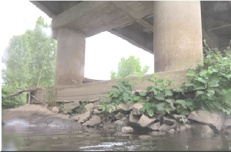
Etat d'énrochement de protection de la pile P2 Rive droite – côté aval
