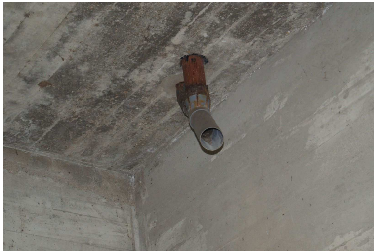
Gargouille obstruée Trace d'humidité et calcite sèche
