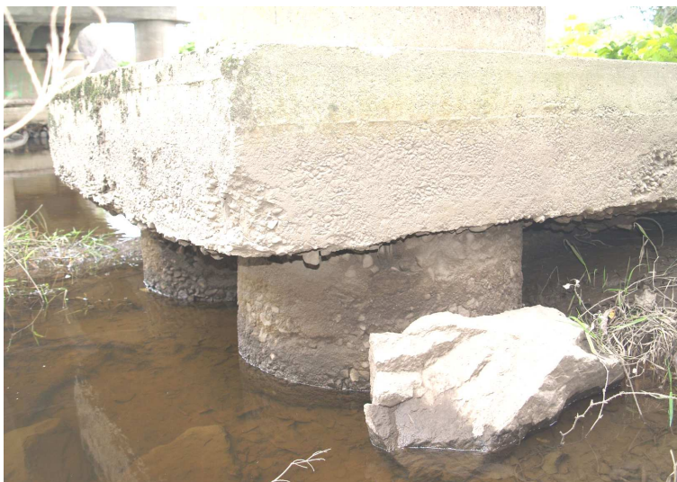
Affouillement et mise à nu des pieux de la pile P1 Rive Gauche – côté aval
