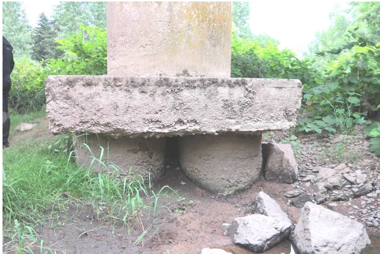
Affouillement et mise à nu des pieux de la pile P1 Rive Gauche – côté aval
