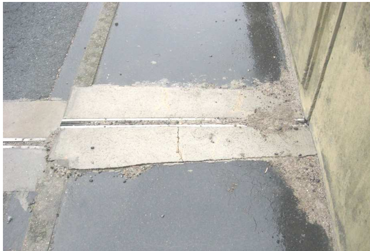
Joint de trottoir encombré - côté amont RD
