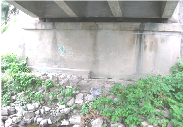
Vue sur l'état des enrochements et berge de la culée rive droite
