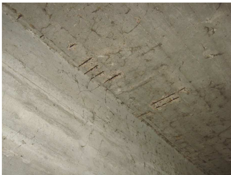
Aciers apparents corrodés – intrados du tablier
