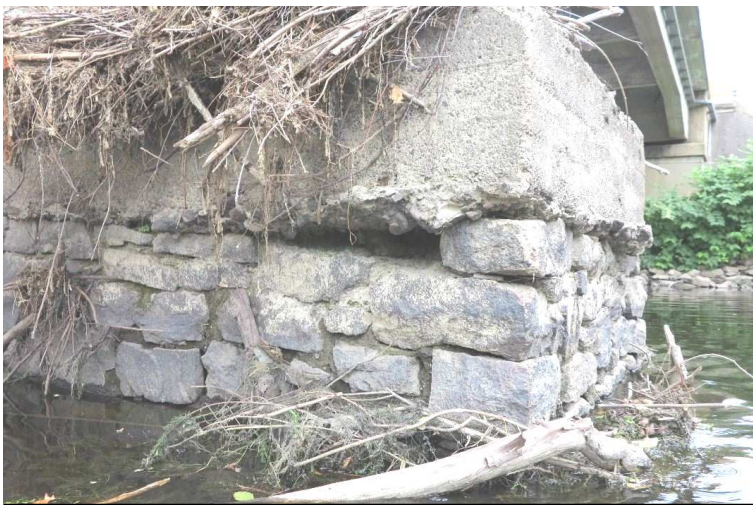
Etat de la maçonnerie de la pile P2 – côté amont
