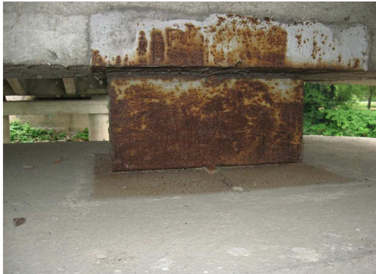
Epaufrure et aciers apparents - Poutres longitudinales côté aval
