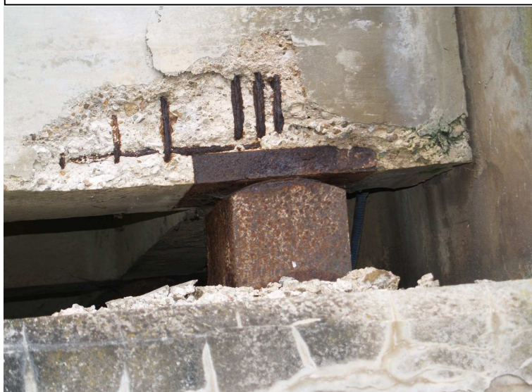
Eclatement de béton, Corrosion des aciers apparents Poutre longitudinale et appareils d'appui mobile de la culée rive gauche - côté aval
