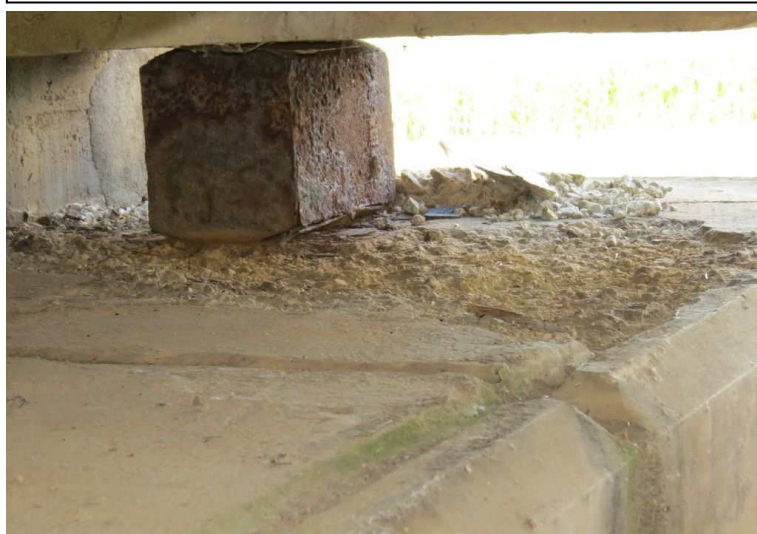
Désagrégation du béton – côté aval rive gauche
