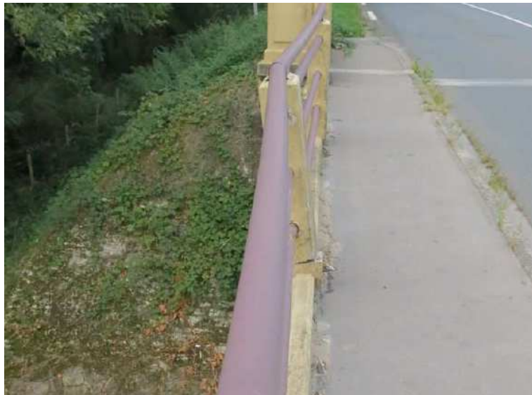
Garde-corps accidenté - côté amont rive gauche
