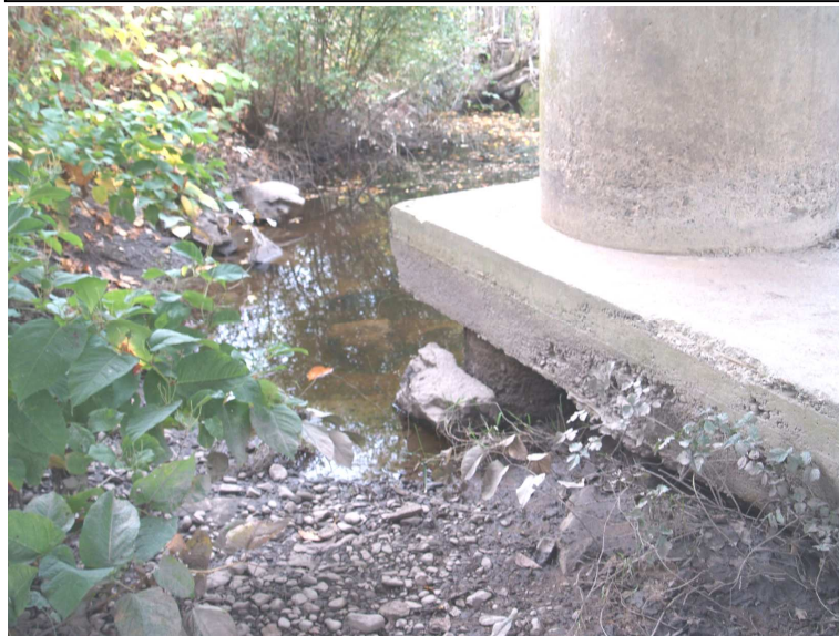
Trou créé par le remous au droit de la pile P1 - Rive Gauche
