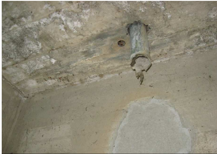
Stalactite sur hourdis – Intrados du tablier en béton armé
