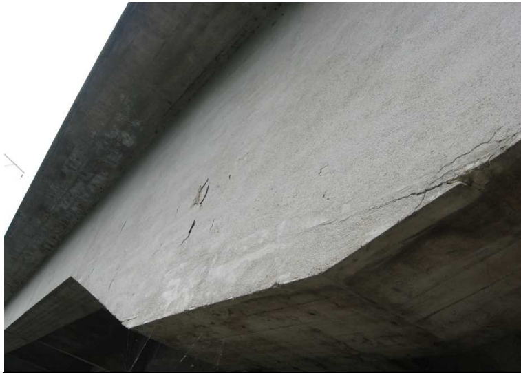
Epaufrement et aciers apparents - Poutres longitudinales côté aval
