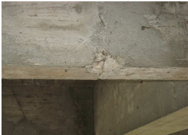
Eclat de béton – entretoise intermédiaire
