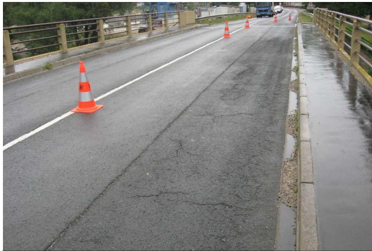
Fissure et orniérage le long de la chaussée, végétation à la naissance et dépôt des gravillons sur la longueur du caniveau – Coté Amont
