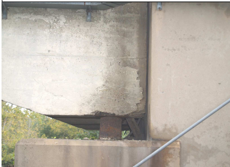
Corrosion et inclinaison des appareils d'appuis rive droite - coté amont
